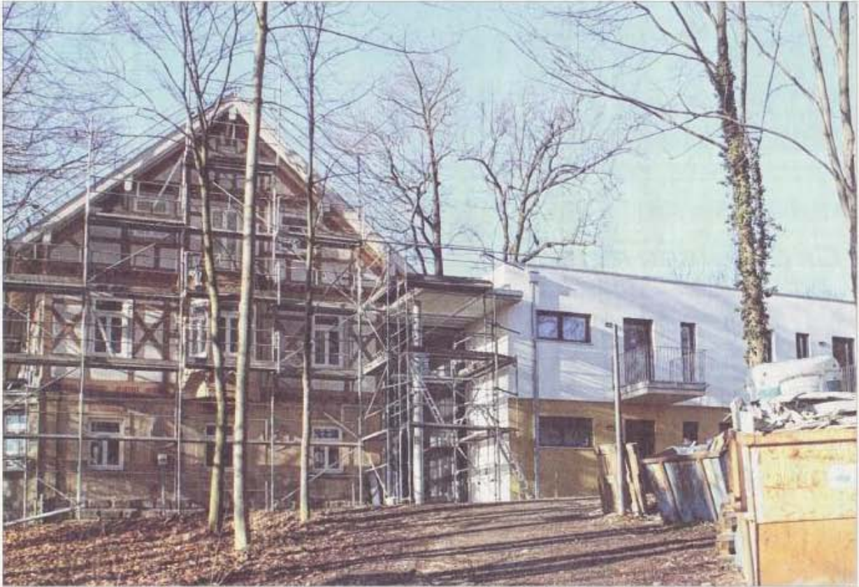
Die Bauarbeiten am Hospizhaus in Faurndau gehen zügig voran. In diesen Tagen soll mit der Einrichtung begonnen werden, der Betrieb wird im Mai aufgenommen. Die offizielle Einweihung findet am 20. April statt. Foto: Staufenpress
