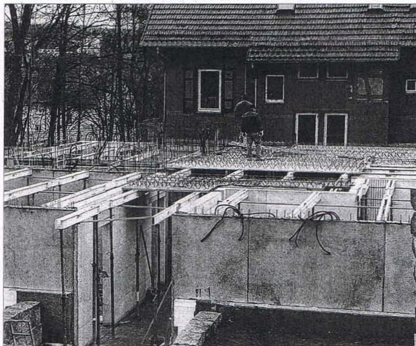
Im Erdgeschoss des Neubauteils wird schon die Decke in Angriff genommen. Dort liegen später die Patientenzimmer. Der Altbau der Villa Hammer im Hintergrund wird nach der Sanierung Verwaltungsräume und Besprechungszimmer beherbergen. Die NWZ-Leser helfen zum wiederholten Mal beim Bau des stationären Hospizhauses. Foto: Staufenpress
