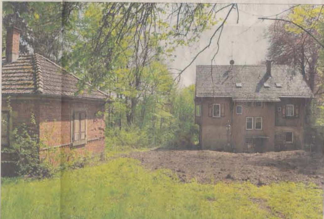
Nach den ersten Vorarbeiten im Faurndauer Hammer-Park soll nun mit dem Bau des Hospiz begonnen werden. Auf der Fläche im Vordergrund entsteht der Neubau, der an die bestehende Hammer-Villa angedockt wird. Foto: Giacinto Carlucci
